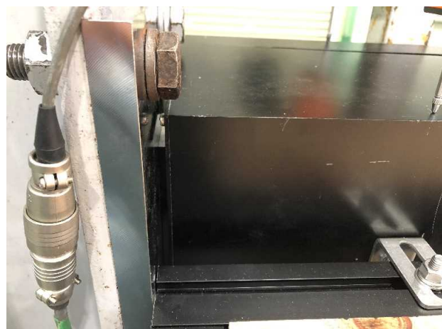
写真5.2.4 試験前状況 マリオン下部
