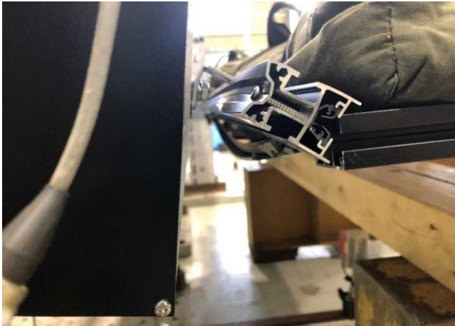
写真5.1・13 縦柱と上枠の接合部（外部側） ビスの抜け、縦柱の変形
