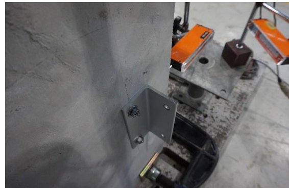
写真5.1・34 試験後のブラケット状況 マリオン上部
