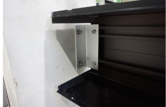
写真5.2・26 試験後のブラケット状況 マリオン上部
