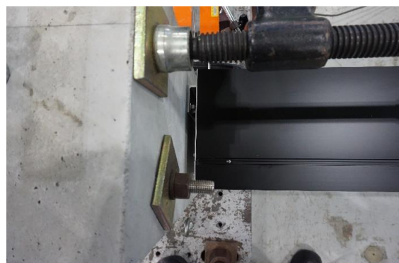
写真5.2・4 試験前状況 マリオン上部
