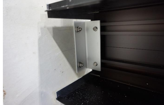
写真5.1・32 試験後のブラケット状況 マリオン上部
