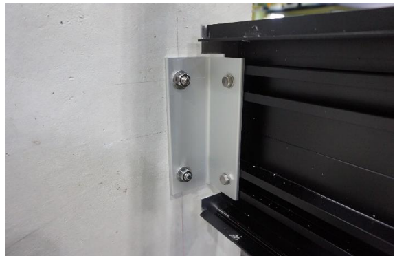
写真5.3・34 試験後のブラケット状況 マリオン上部
